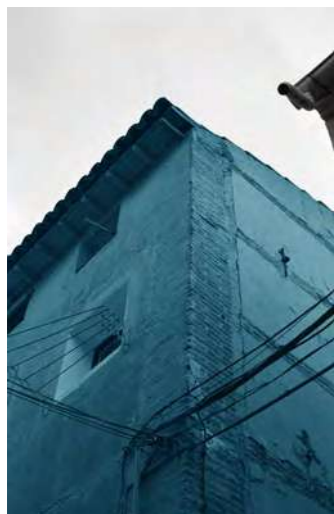
03 Edificio conformado por muros con machones y verdugadas de ladrillo en calle San Juan Alta
